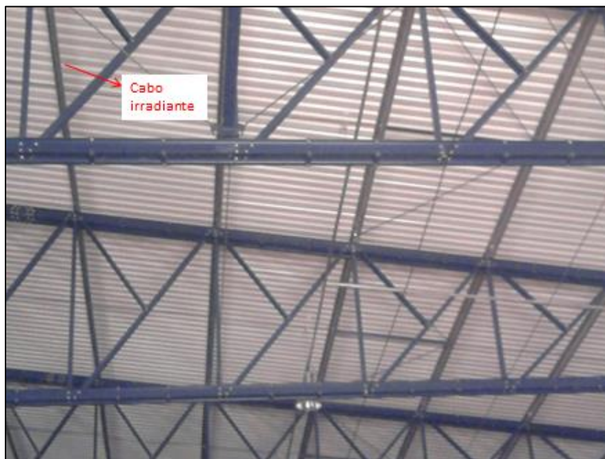
Figura 68 - Cabo irradiante instalado em Galpão
