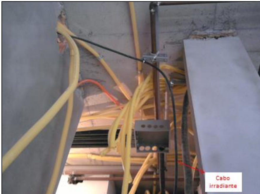
Figura 72 - Cabo irradiante instalado em apartamento
