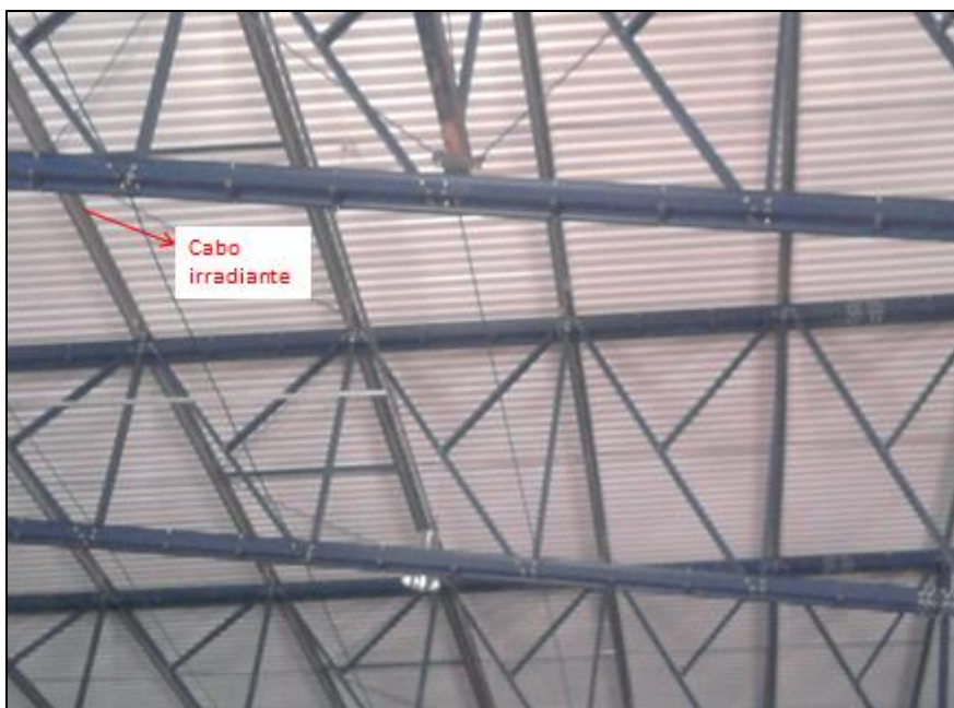
Figura 70 - Cabo irradiante instalado em Galpão
