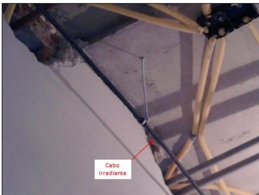
Figura 75 - Cabo irradiante instalado em apartamento
