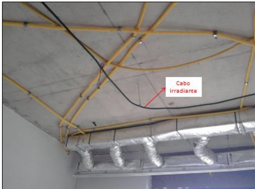
Figura 73 - Cabo irradiante instalado em apartamento
