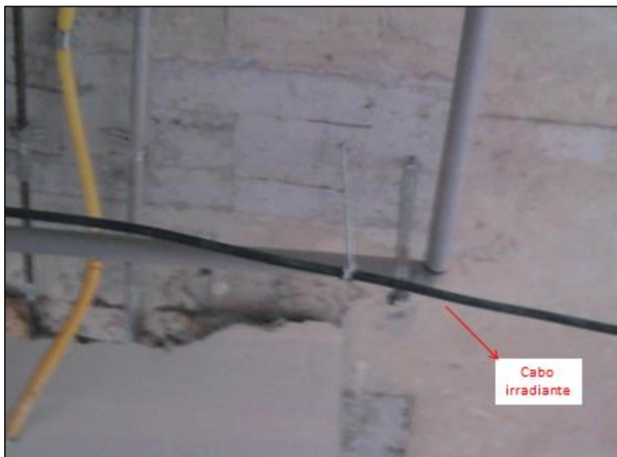
Figura 71 - Cabo irradiante instalado em apartamento
